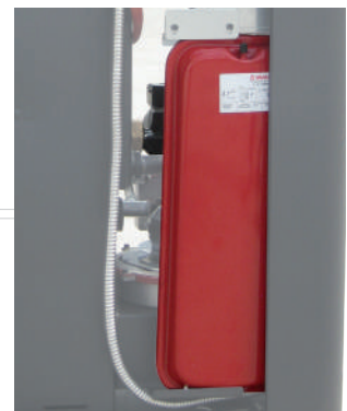
VASO DI ESPANSIONE
