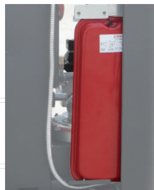
VASO DI ESPANSIONE
